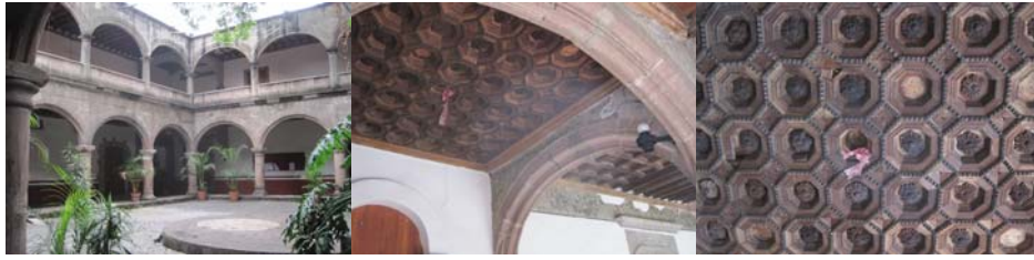
Figura 2. Conservación del artesanado estilo mudéjar en el claustro del conjunto conventual.
