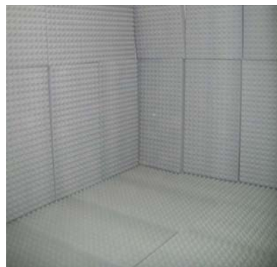
Figura 8. Disposición de los paneles absorbentes en la cámara de recepción
